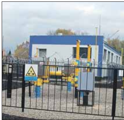
Такая станция позволит снабжать газом весь город
