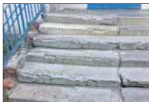
Сама конструкция ступенек влечёт их разрушение
