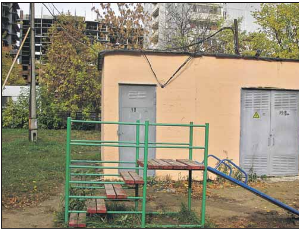
На Олимпийском проспекте, 36, корп. 1, кабели свисают над детскими площадками
