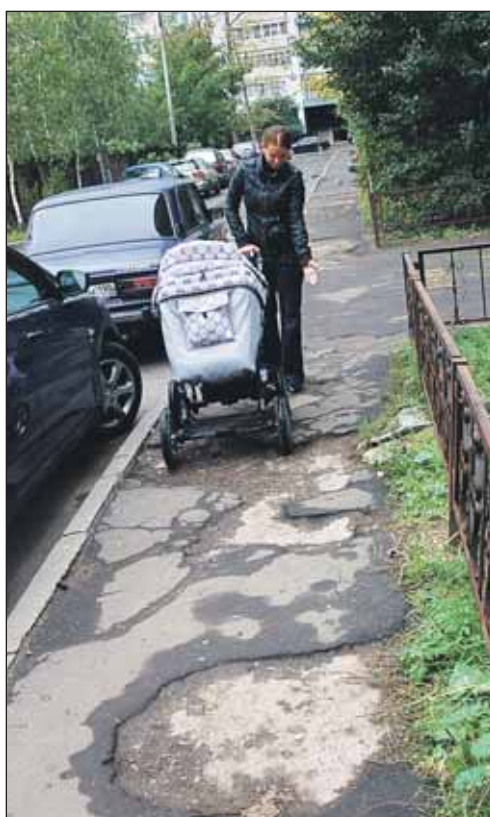
Выбоины на улице Терешковой, 2, корпус 1
